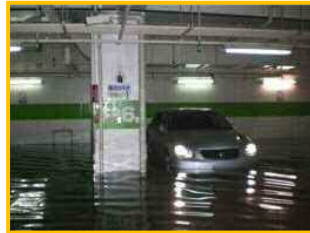
地下2階の浸水状況
