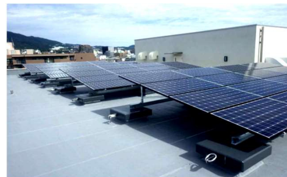
東館屋上の太陽光発電
