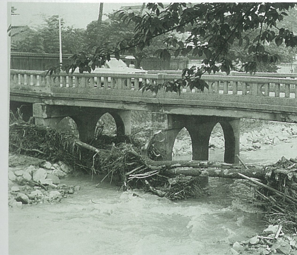
月若橋付近 昭和42年7月の集中豪雨のようす。上流からの流木がひっかかった月若橋の橋げた。
