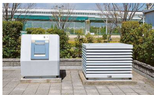
南芦屋浜地区にあるパイプライン施設(写真は投入口)
