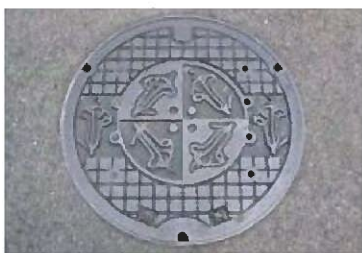
雨水用マンホール
