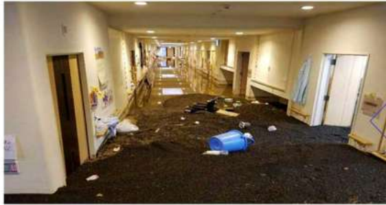
施設1階に土砂が大量に流入したが、全員無事 写真提供: 静岡県小山町
