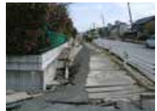
地面のひび割れ
