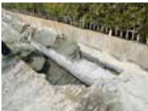
埋設配管の浮き上がり
