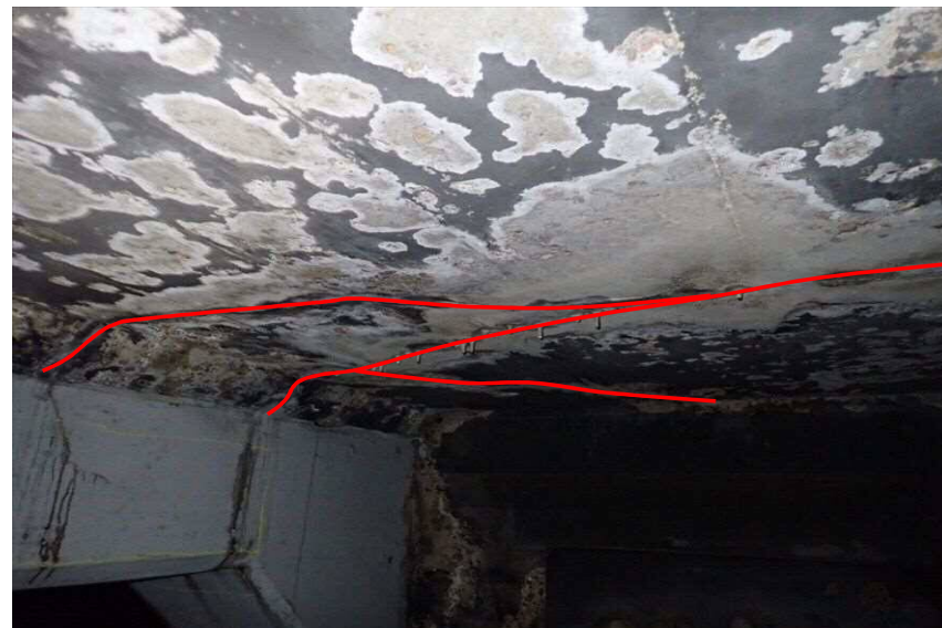
上部構造（床版）漏水・遊離石灰
