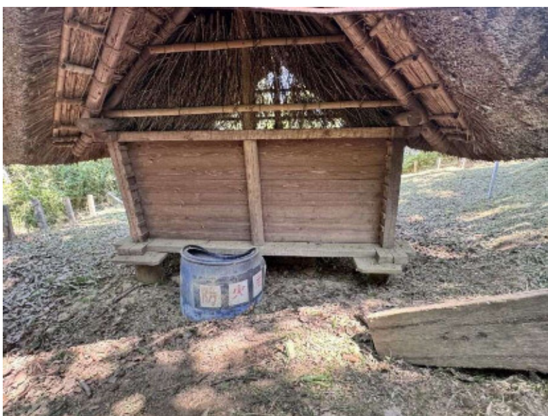
J 地区復元高床倉庫 近景 不等沈下を起こし、大きく傾いている。
