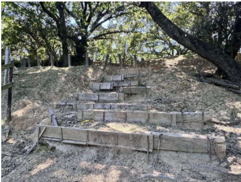
X・U地区間見学道 土砂流出により階段の土留め板が浮いている
