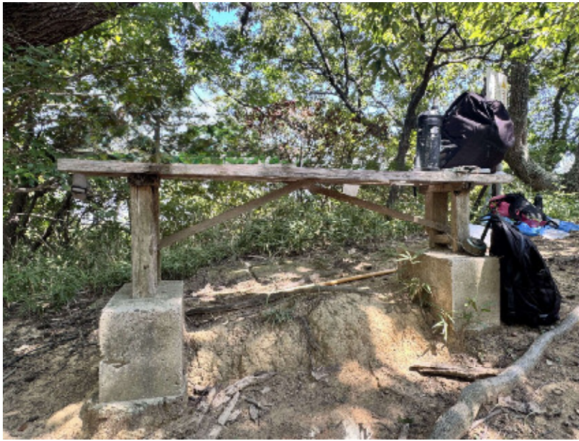
C地区付近のベンチ① 土砂流出により基礎が剥き出しになっている。
