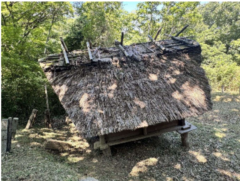
J 地区復元高床倉庫 近景 不等沈下を起こし、大きく傾いている。
