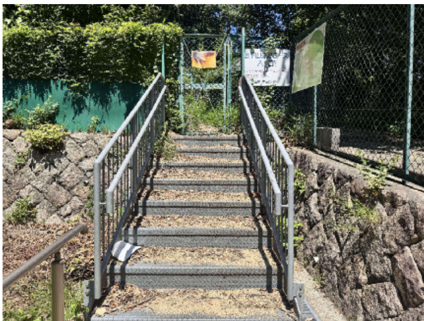
会下山遺跡入口 遠景 土砂が流出している。
