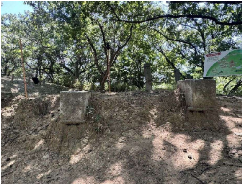
C地区付近のベンチ② 土砂流出により基礎が剥き出しになっている。
