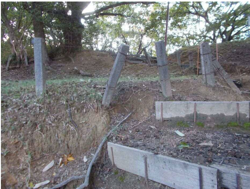
47 X地区北側 土砂流出が著しく、階段や遺構を囲むコンクリート製の柵が浮いている。雨水の流れによって水みちができ、見学道が侵食されている。 (地図地点：16)
