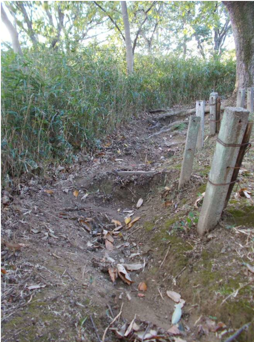
60 L地区南側見学道 土砂流出が著しく、雨水の流れによって水みちができ、見学道が侵食されている。
