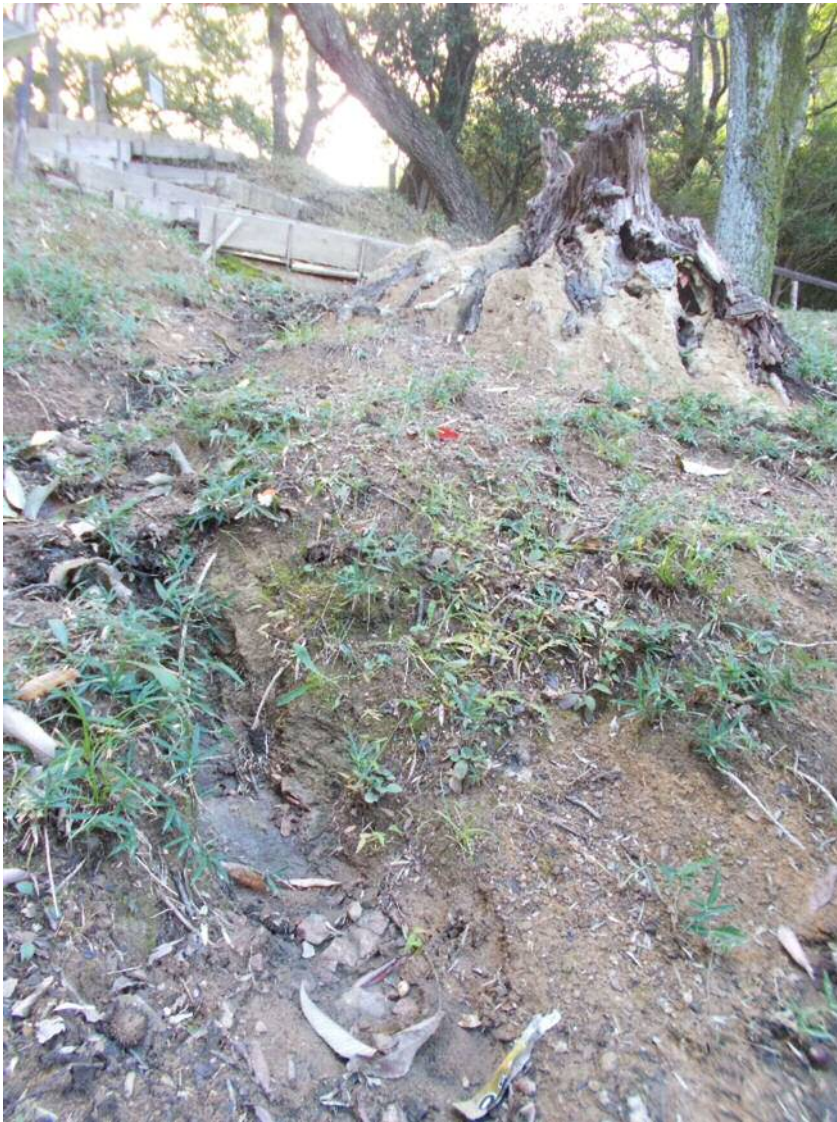
52 N地区北側見学道 土砂流出が著しく、雨水の流れによって水みちができ、見学道が侵食されている。
