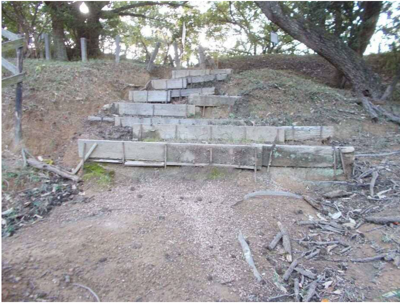
49 X地区北側見学道 土砂流出が著しく、階段の土留め板が浮いている。雨水の流れによって水みちができ、見学道が侵食されている。 (地図地点：16)
