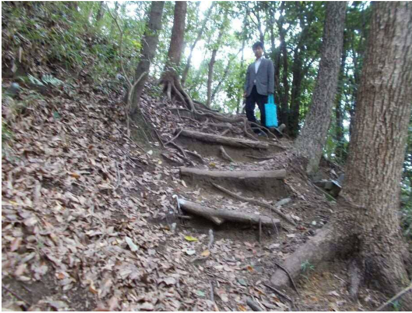
10 見学道 土砂流出により見学道の階段の踏み板が浮いている。 (地図地点：04)
