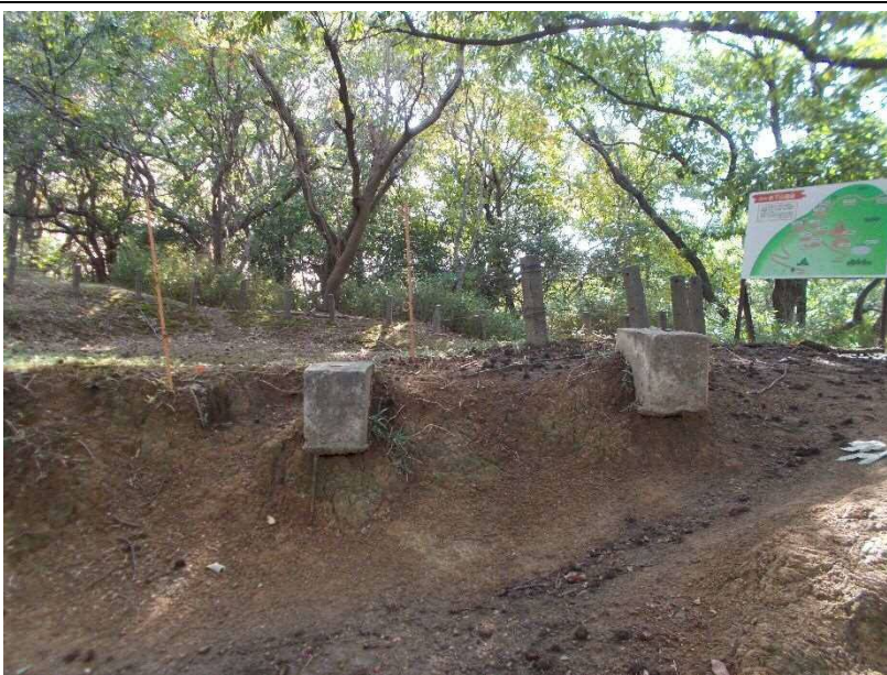
29 C地区北側ベンチ 土砂流出により基礎が完全に 露出している（倒壊の危険性 があるため上部は撤去）。
