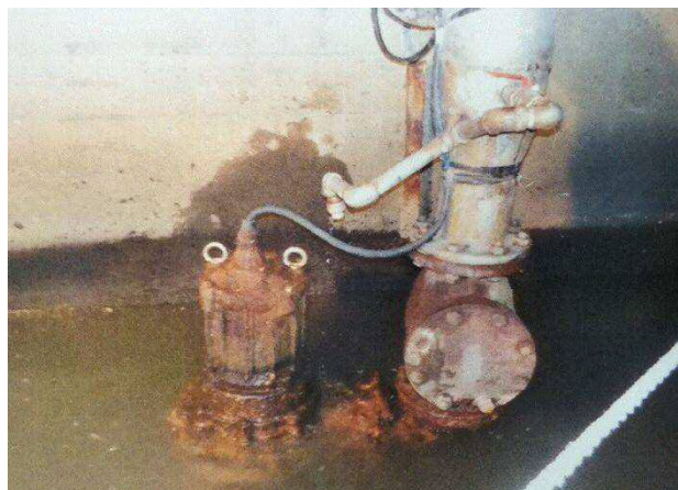
写真 2 設備の老朽化状況
