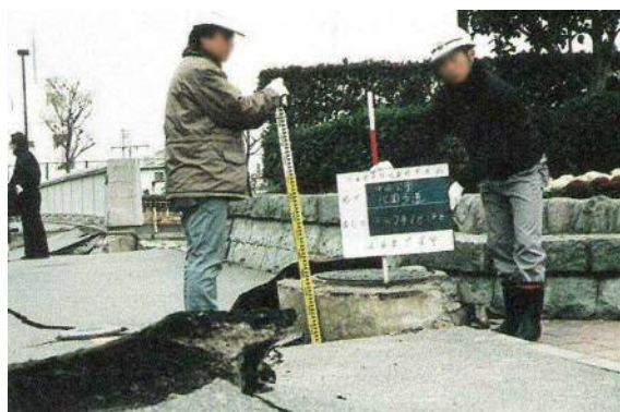
液状化によるマンホール突出
