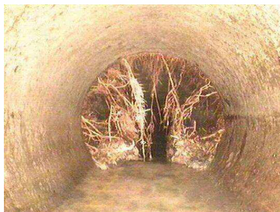
写真1 管路の老朽化状況
