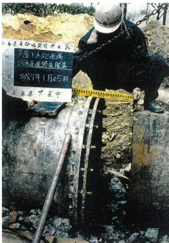
汚水管路の脱落
