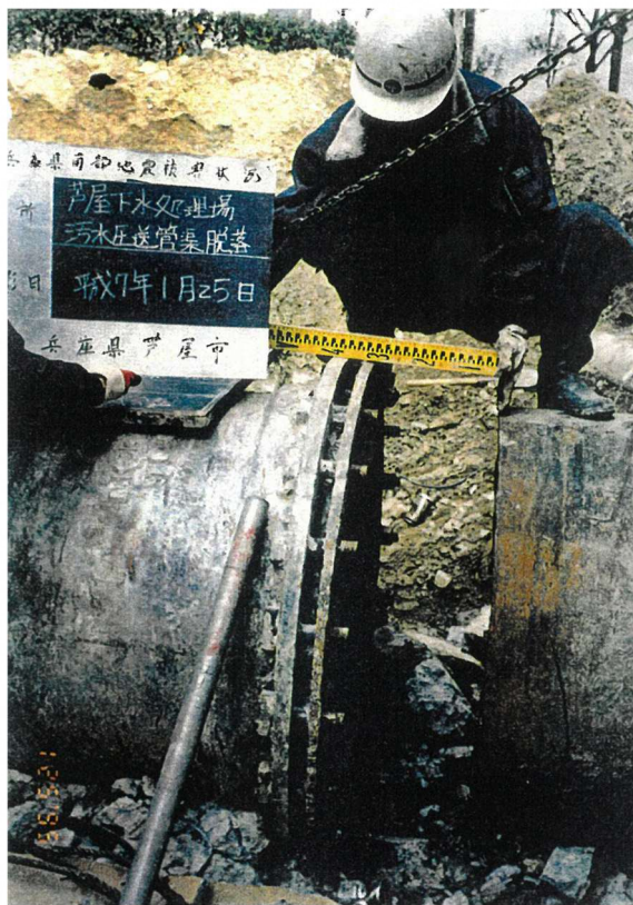
汚水管路の脱落
