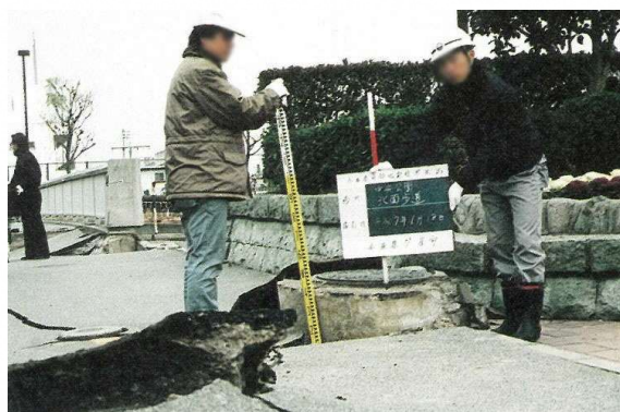
液状化によるマンホール突出
