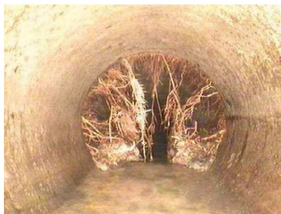
写真1 管路の老朽化状況
