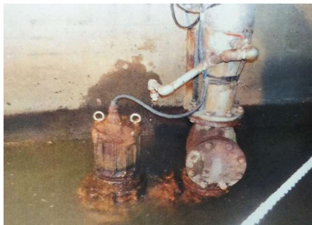
写真 2 設備の老朽化状況
