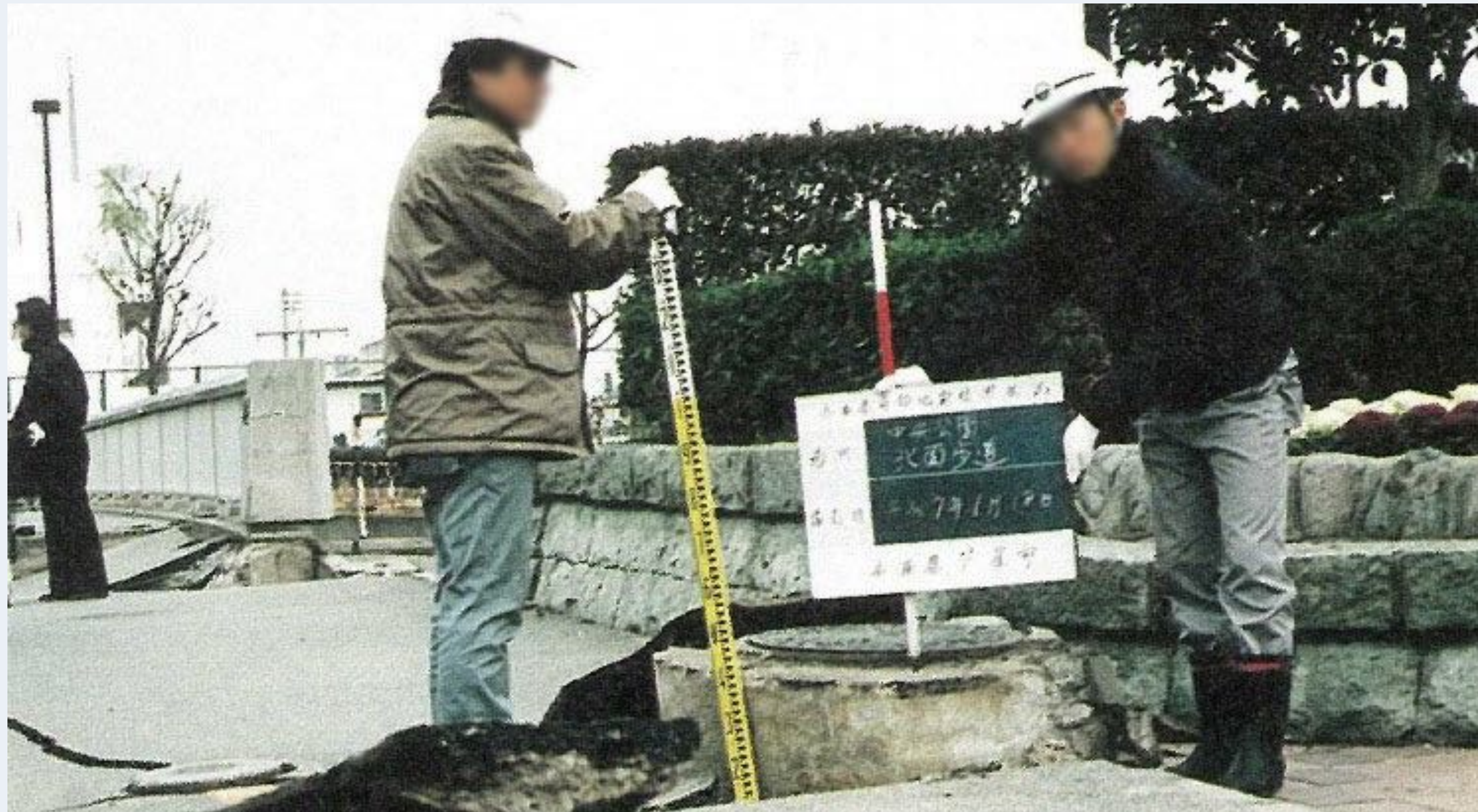
液状化によるマンホール突出
