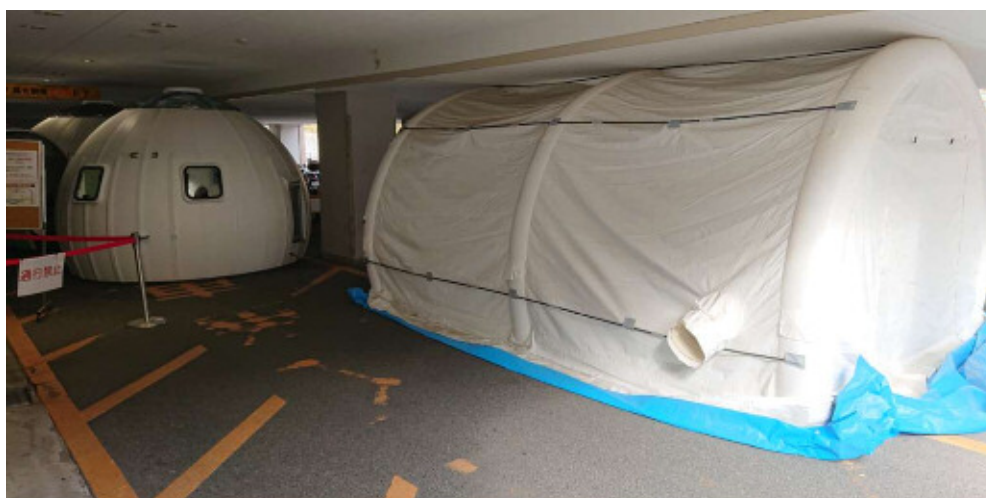
* 陰圧テント等の設置の様子
