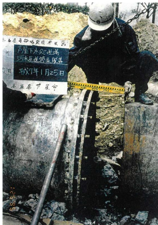
汚水管路の脱落
