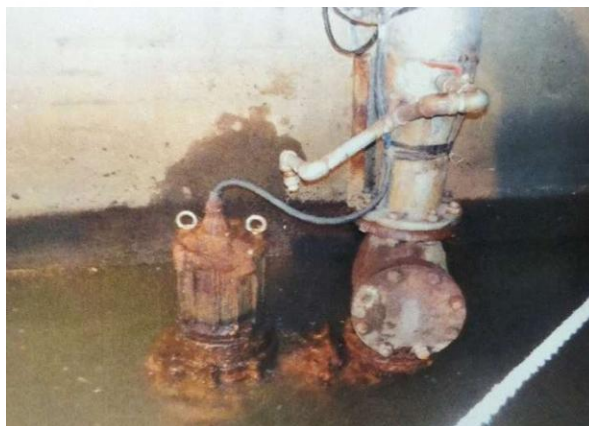
写真 2 設備の老朽化状況
