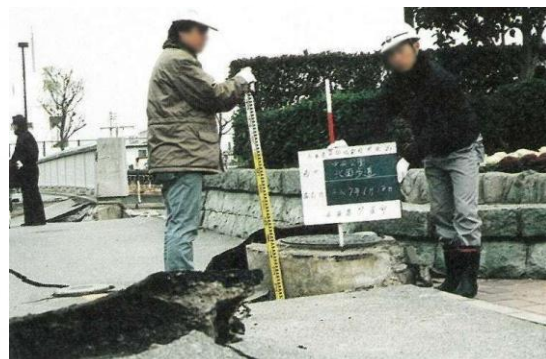
液状化によるマンホール突出
