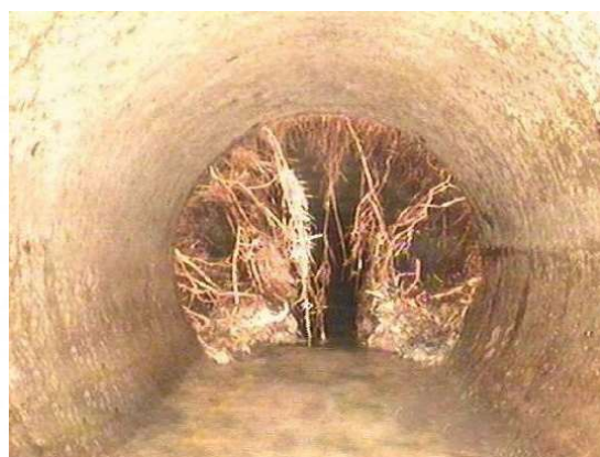
写真1 管路の老朽化状況
