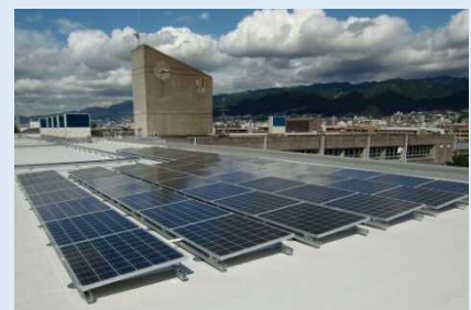
打出浜小学校に設置した太陽光発電システム
