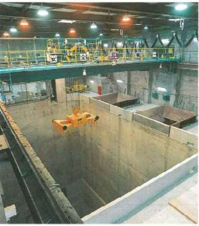
ごみピットとごみクレーン 収集ごみを回収します。
