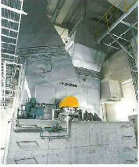
集じん機 焼却炉で発生する粉じんを回収・処理します。
