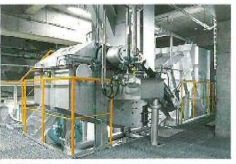
灰押出装置 ごみの焼却灰を冷却して、灰ピットへ送り出します。
