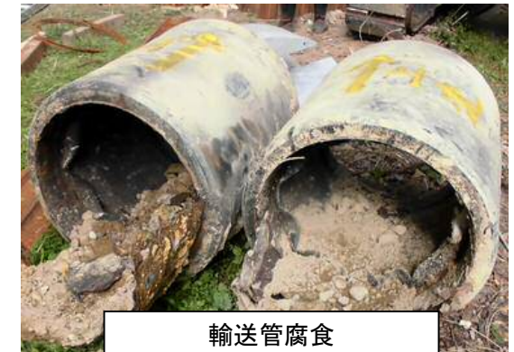
輸送管腐食(約1700X200mm) 2016年8月(浜風町10)
