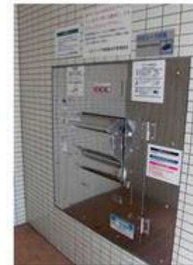
ごみドラム投入口
