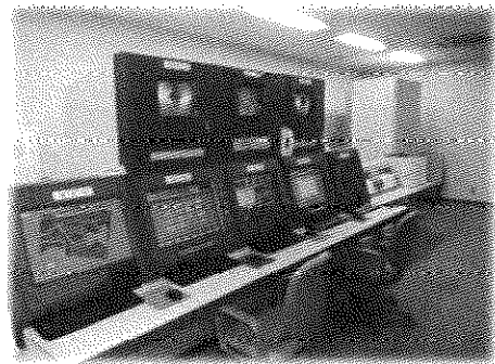
パイプライン施設 中央制御室
