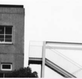
校舎から外れてしまった非常階段(平成7年・潮見小学校)
