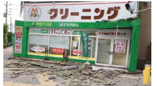
大阪府北部地震で外壁が崩れた店舗(茨木市)
