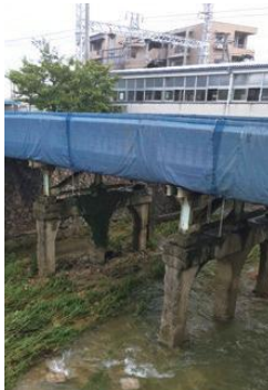
阪急芦屋川駅北側の築60年以上経過している桜橋。2本の橋脚に土石や流木が堆積すると土砂ダムとなり氾濫する危険が生じる。
