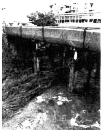
土石や流木が堆積して土砂ダムとなり、氾濫する可能性がある阪急芦屋川駅北側の桜橋
