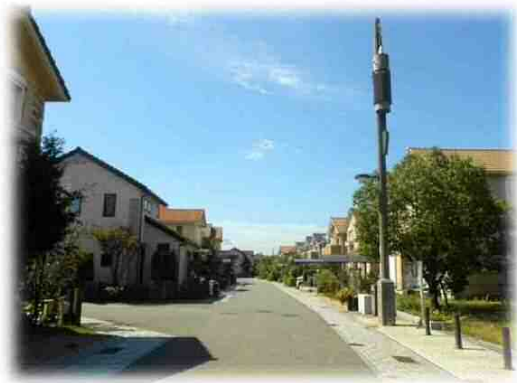
柱上型機器（海洋町）
