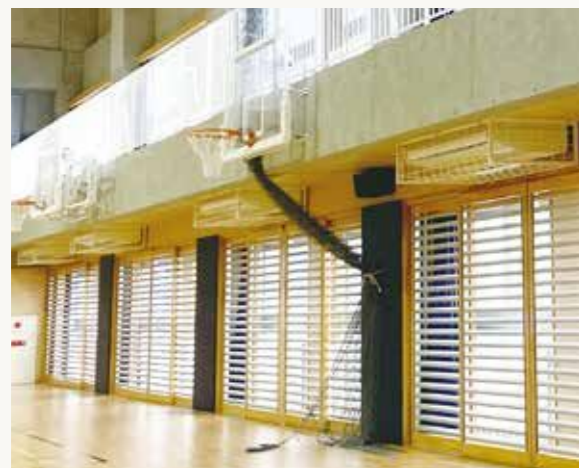
設置された空調設備
