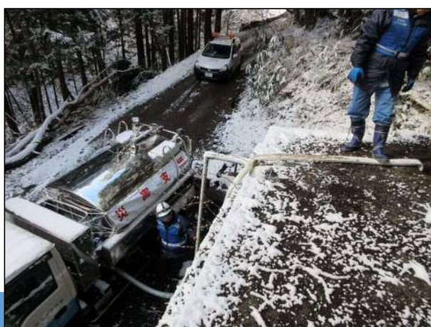
河内集会所上流タンクへの給水
