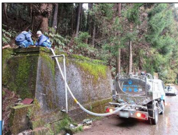
河内集会所上流タンクへの給水
