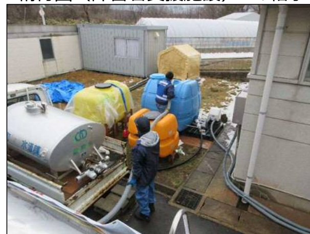
精育園（障害者支援施設）への給水
