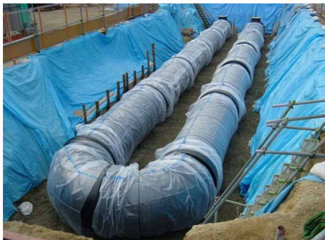
平成15年度 岩園小学校(耐震性貯水槽 100 m 3 )
