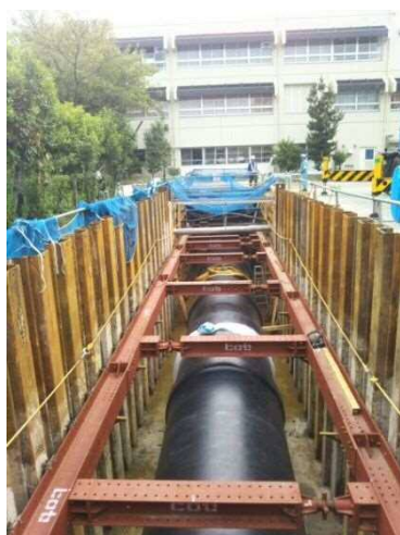
平成30年度 打出浜小学校 (耐震性貯水槽 100 m 3 )
