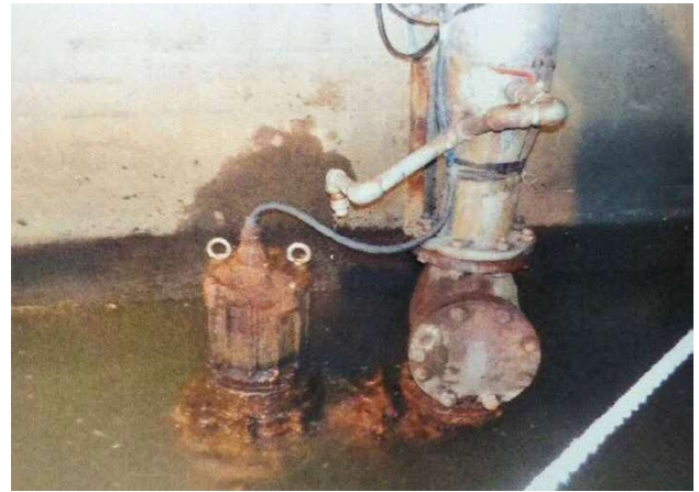
写真2 設備の老朽化状況
