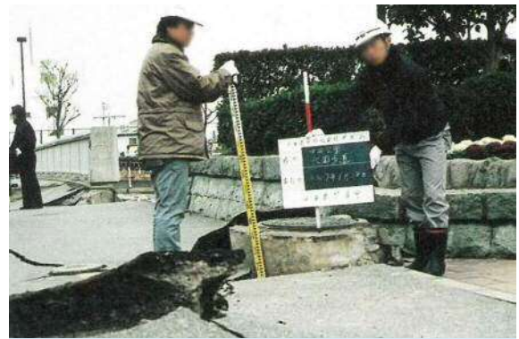
液状化によるマンホール突出
