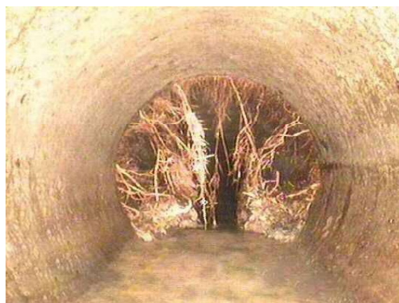
写真1 管路の老朽化状況
