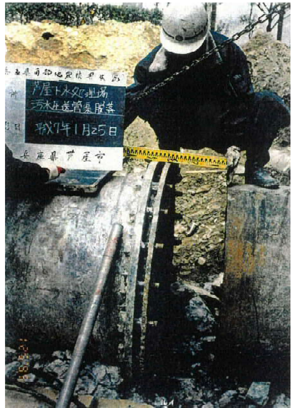
汚水管路の脱落
