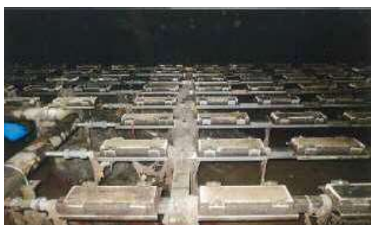
改築前 劣化により機能が低下した散気装置
