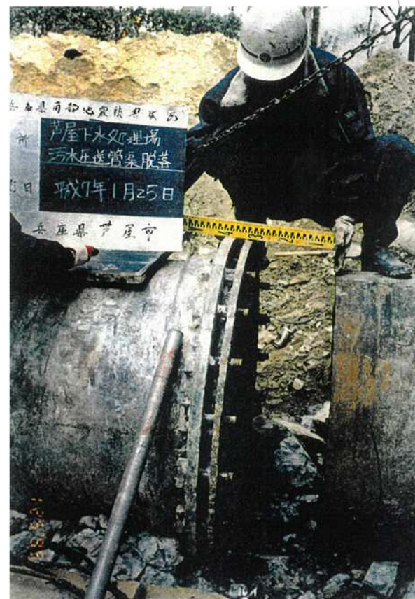
汚水管路の脱落
