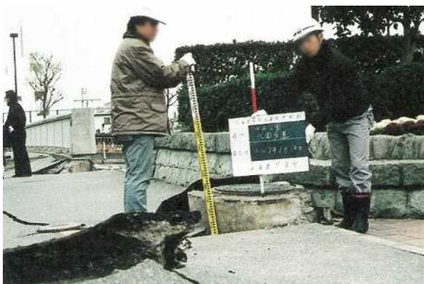
液状化によるマンホール突出
