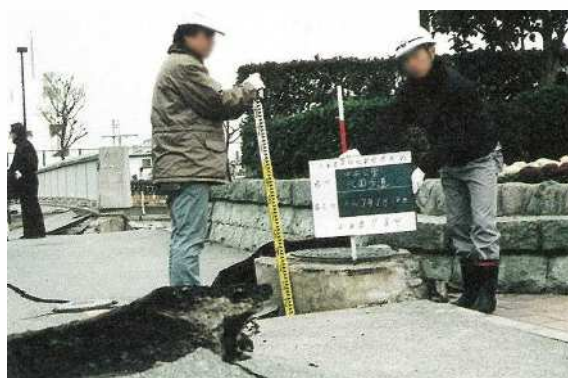
液状化によるマンホール突出
