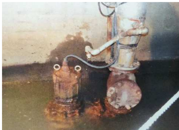
写真 2 設備の老朽化状況
