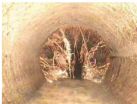
写真1 管路の老朽化状況
