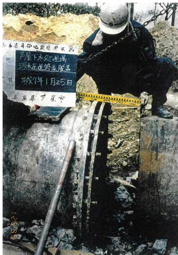
汚水管路の脱落
