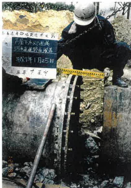
汚水管路の脱落
