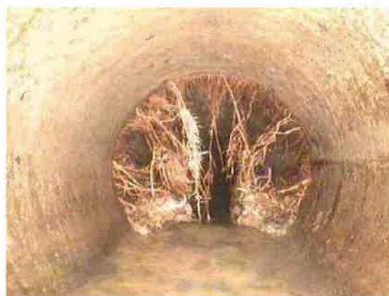
写真1 管路の老朽化状況
