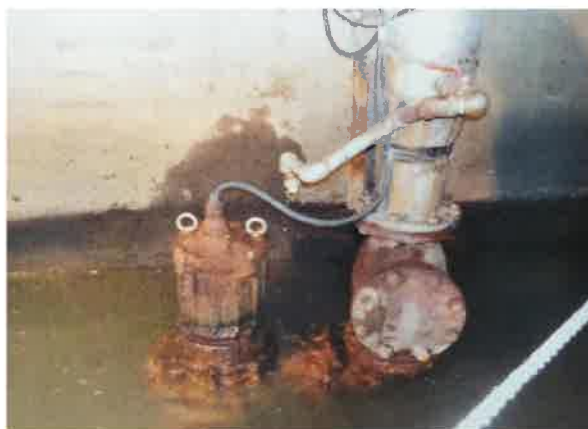
写真 2 設備の老朽化状況
