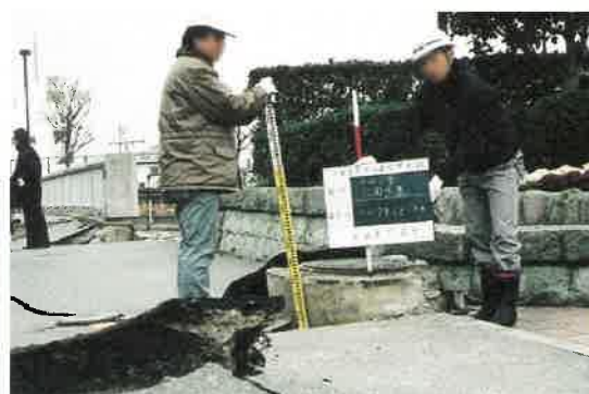
液状化によるマンホール突出
