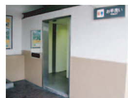
▲出入口に段差があり,車いすトイレが無い
