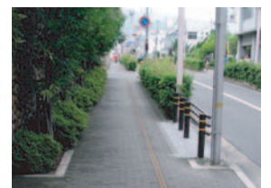
▶ 視覚障害者誘導用ブロックの形状が小さく識別しにくい
