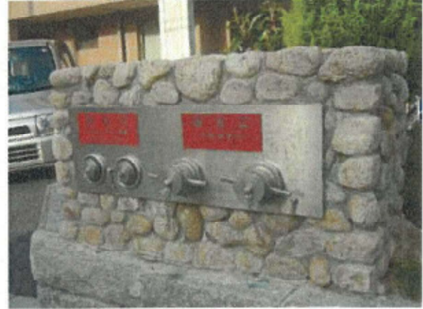
消火設備（送水口等）を石積み風とすることで、周辺との調和を図っている例
