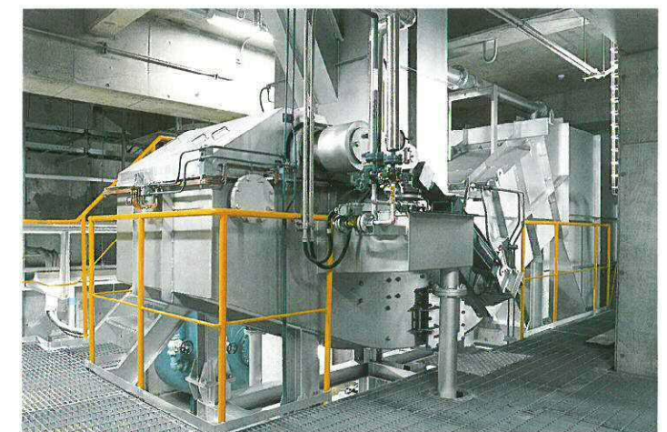
灰押出装置 ごみの焼却灰を冷やして、灰ピットへ送り出します。
