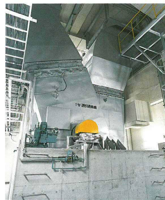
誘引送風機 焼却炉で発生する排ガスを煙突へ誘導します。
