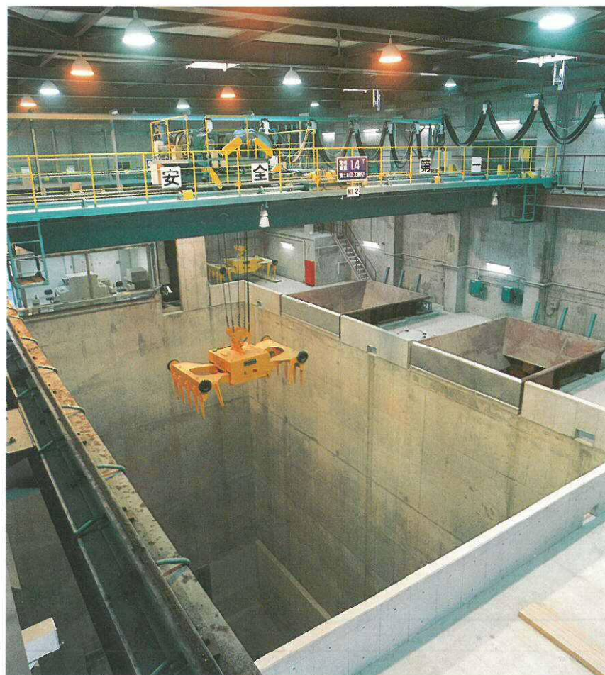
ごみピットとごみクレーン 収集ごみを貯留します。
